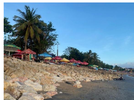
Gambar 3. Kondisi Abrasi di Pantai Kuta Sumber: Dokumentasi Peneliti (2026)
