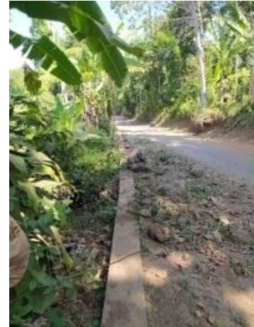
Gambar 14. Sistem Drainase yang Kurang Baik Sumber: Tim Matching Fund UP
